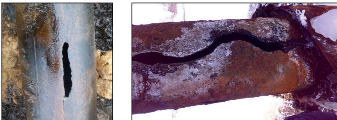
Рис. 4.1. Коррозия нефтесборного промышленного трубопровода
