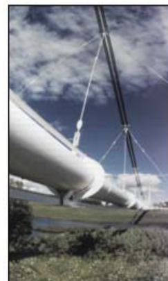
Рис. 1.10. Надземная прокладка трубопровода
