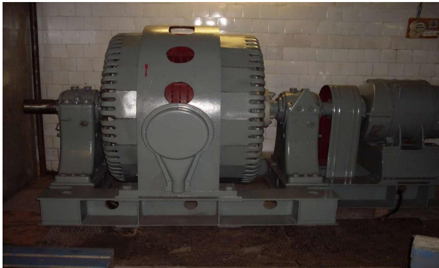
Рис. 3. Общий вид электропривода насоса
