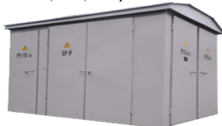
Рис. 1. Комплектная трансформаторная подстанция
