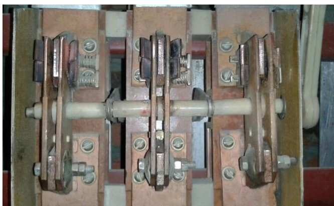
Рис. 3. Рубильник вводной секции
