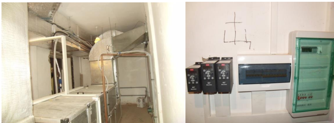
Рис. 5. Регенеративная вентиляционная установка в КузГТУ
