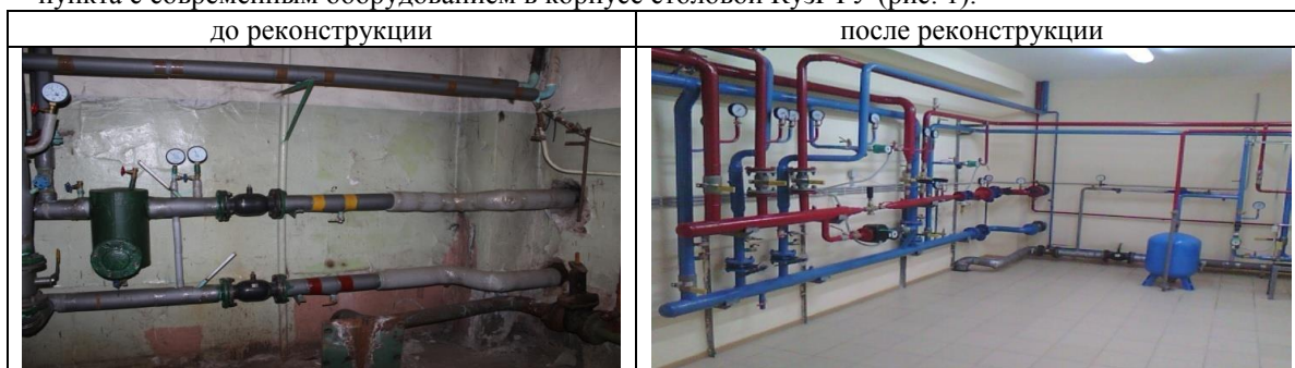
Рис.1. Тепловой пункт в корпусе столовой КузГТУ
