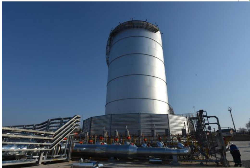
Факельная установка закрытого (наземного) типа
