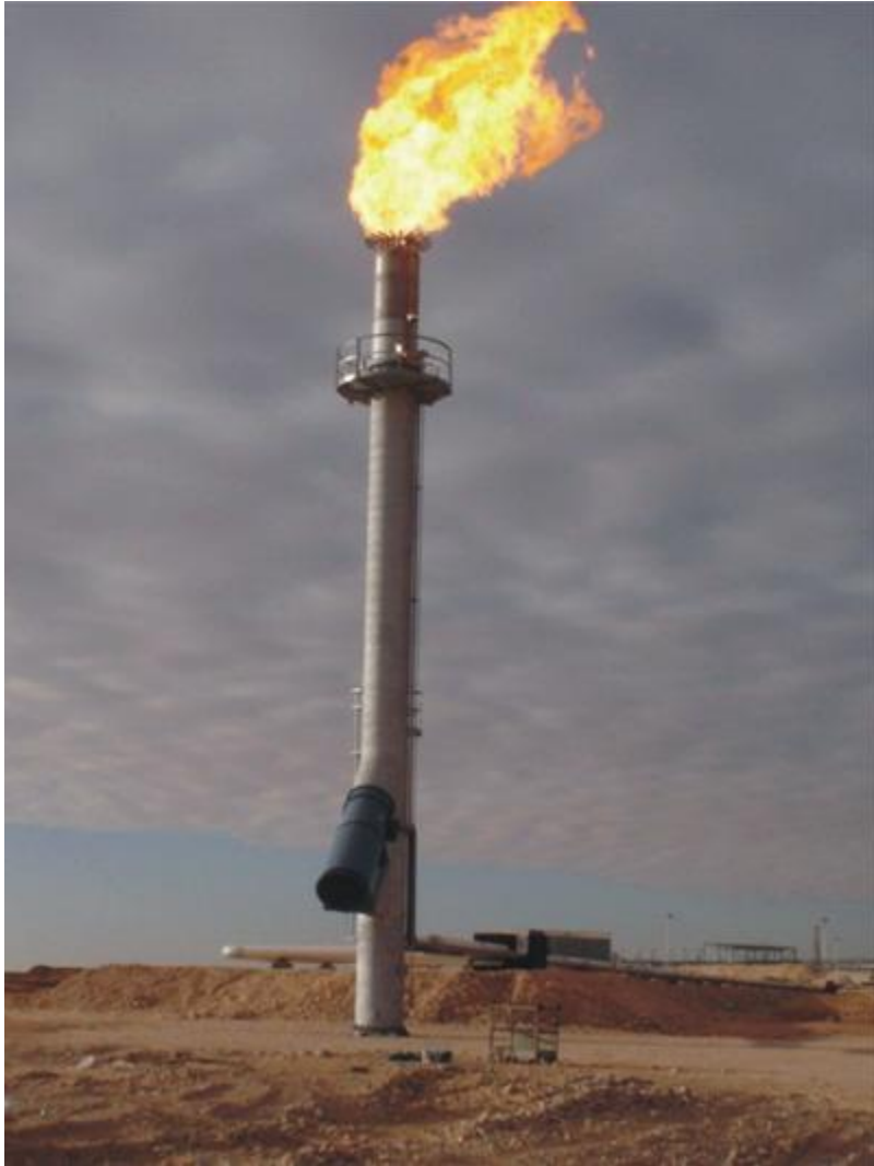
Вертикальные факельные установки
